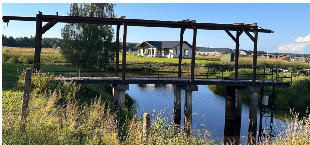
49. attēls Mangaļu poldera sūkņu stacija "Mangaļi"
