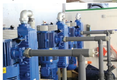
Vakuuma kanalizācijas sūkņu stacija.
