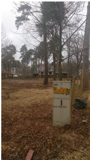
6. attēls. Elektrosadales skapis
